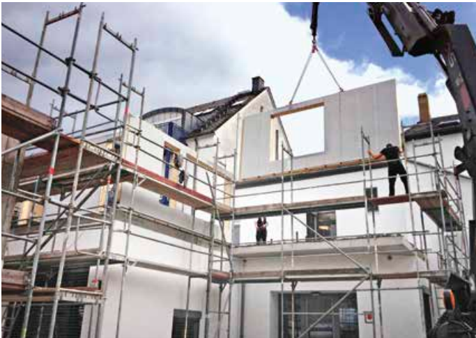
▲ Ein Kran hievte die vorgefertigten Elemente beim Aufstockungsprojekt in Trier an Ort und Stelle
